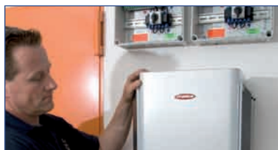
Der Wechselrichter im Keller wandelt Gleichstrom in Wechselstrom
