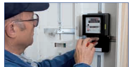
Über den Einspeisezähler wird der Strom ins öffentliche Netz eingespeist
